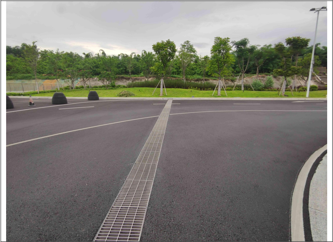
场内排水明沟完善、运行效果良好
