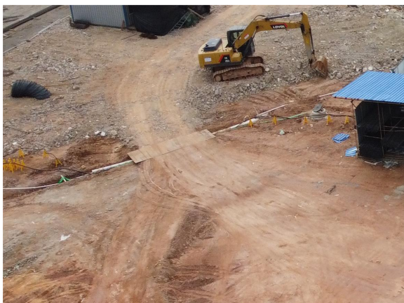
场内雨水井及排水沟
