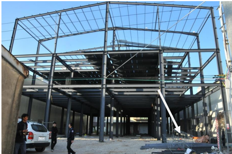
图 1 事故现场情况
