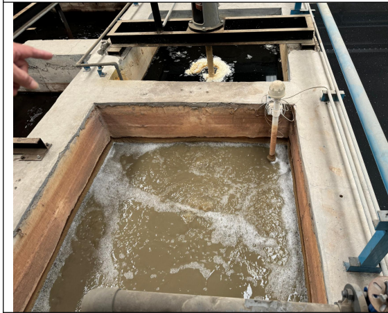
酸性废水混凝池
