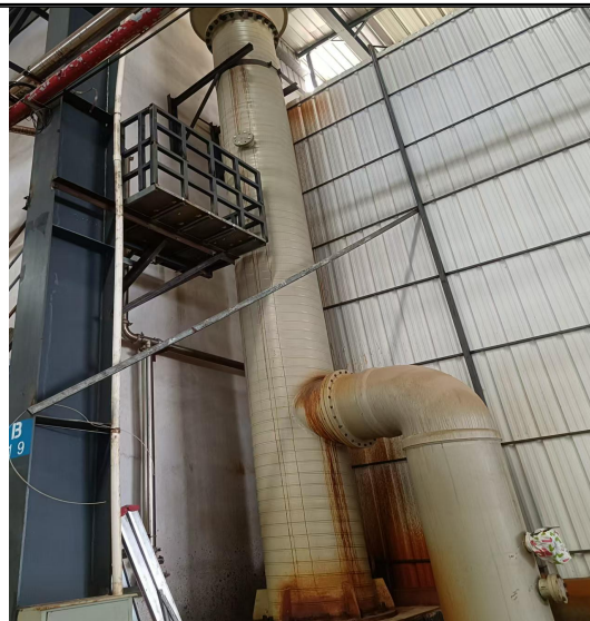
酸雾废气排气筒
