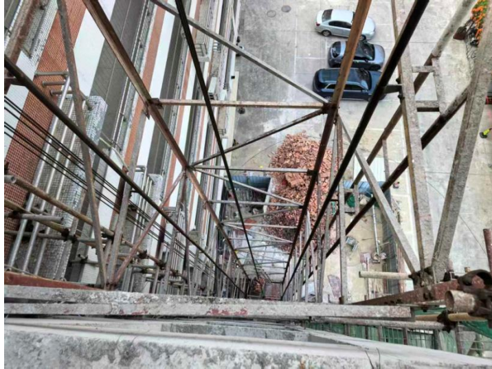
图 1 事故现场情况
