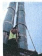
抛光车间2排气筒 (DA002) 处理后
